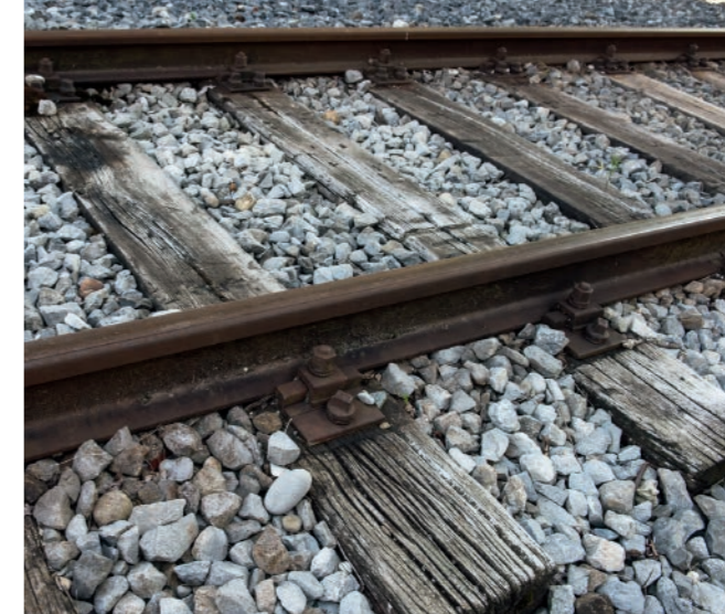
Eisenbahngleise in traditioneller Bauart
